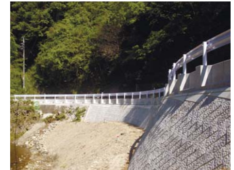
積ブロック直上設置の事例
